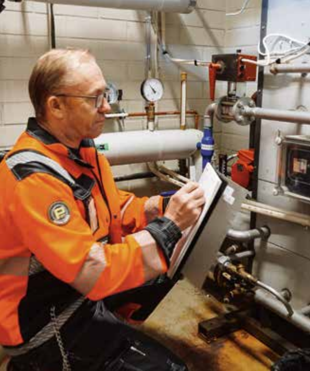
Kiinteistöhoitaja Kari Immonen tarkistaa lämmönjakuhuoneessa Lehtoniemen asuintalojen lämmönkulutusta.
